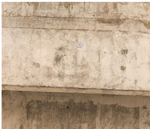
Рис. 5. Раскрытие трещин до 1,0 мм в балках пролета №6
