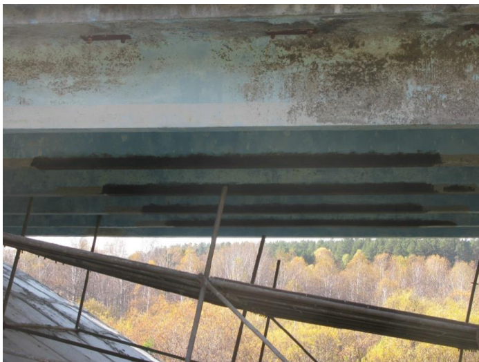
Рис. 2. Усиленное пролетное строение моста
