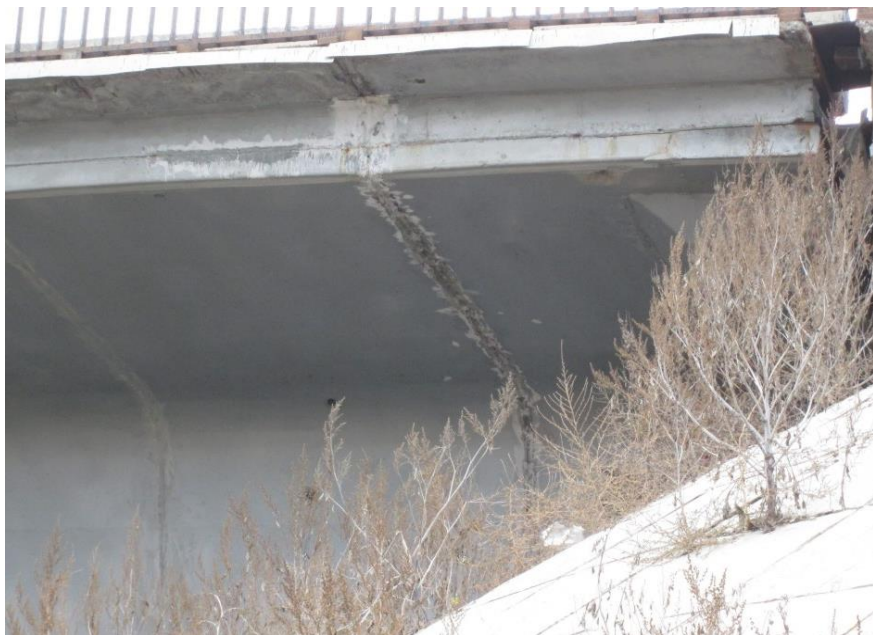
Рис. 3. Пролет 7. Выщелачивание бетона по стыку блоков Б168-Б169 с правой (верховой) стороны
