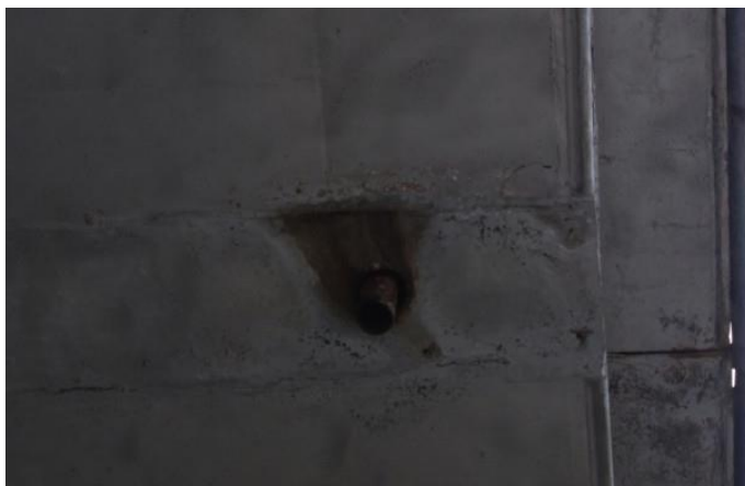
Рис. 2. Пролет 1. Протечка у водоотводной трубки. Выщелачивание бетона.
